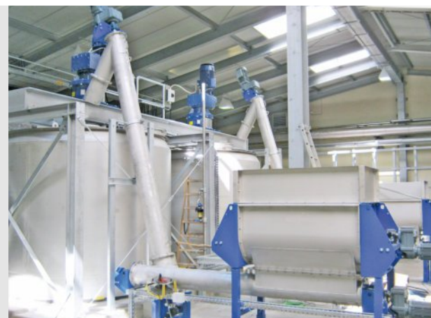
Rohrschneckenförderer befüllen Rührbehälter
