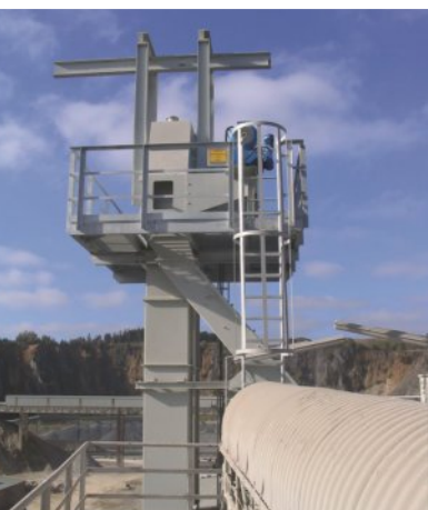
Becherwerkskopf mit Wartungsbühne
